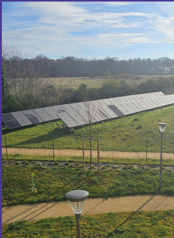
Capteurs solaires pour la Résidence Fontenelle en Normandie.
